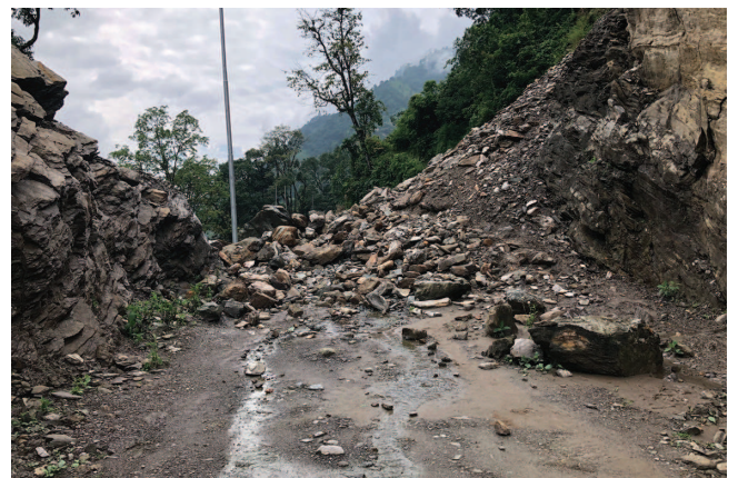
土砂崩れでふさがれた街道
